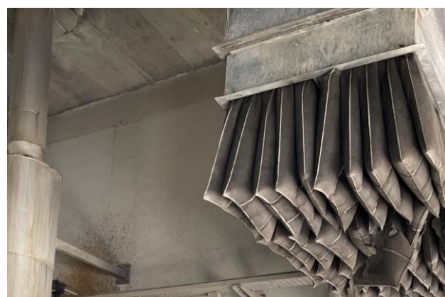
Imagen 3 – Aislamiento filtro-silenciador a sustituir
